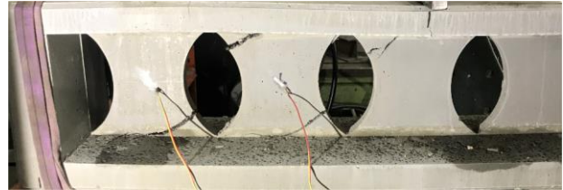
Obr. 13: Analýza módu poškození; foto porušeného vzorku
