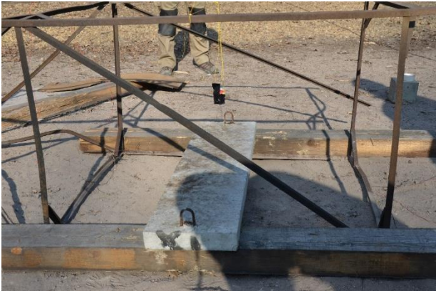
Obrázek 14: Poloha plastické trhliny.
