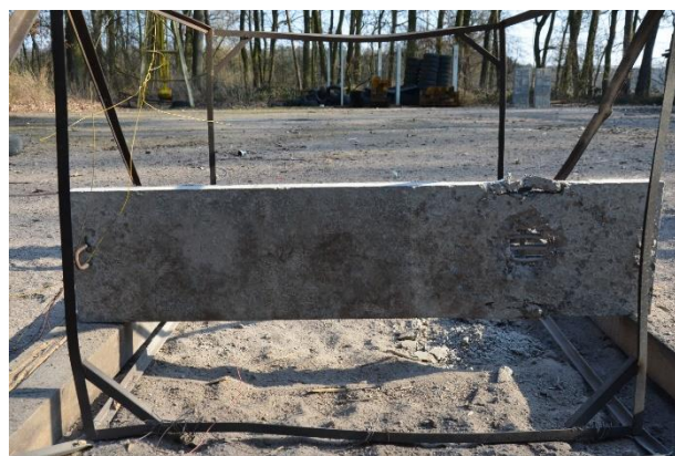
Obrázek 12: Poškození horního povrchu kompozitu, experimentální měření.
