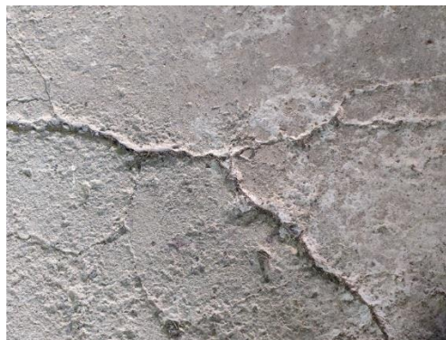
Obrázek 1: Trhliny v betonové konstrukci.
