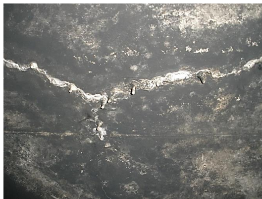
Obrázek 4: Trhlina v desce 1.PP (Procházka a kol., 2019).
