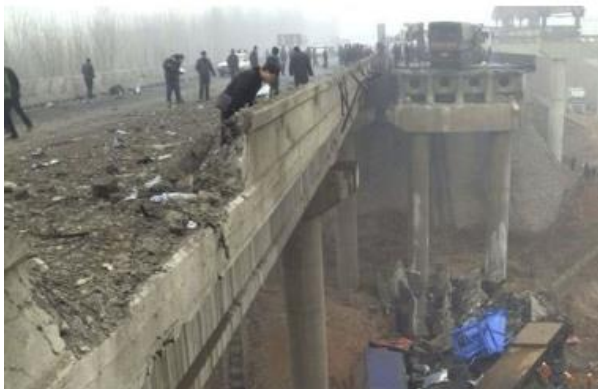
Obrázek 6: Poškozené vetknuté svodidlo [1]
