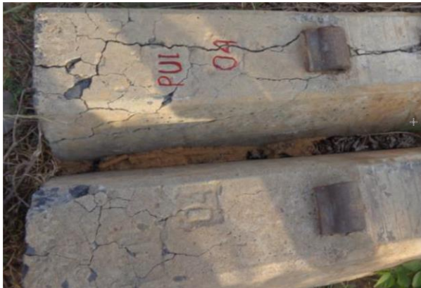
Obr. 1: Pražce porušené formacemi ettringitu, (Awasthi et al. 2017)
