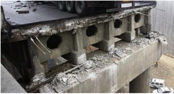
Obrázek 1: Poškozený příčný řez mostu [1]
