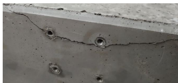
Obrázek 5: Detail porušení přípravku Y – zkouška 3
