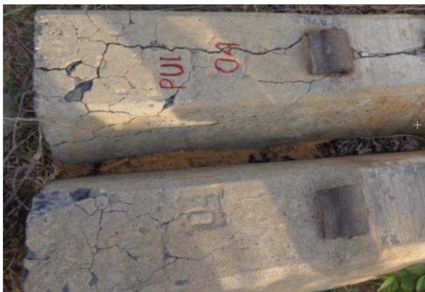
Obr. 1: Pražce porušené formacemi ettringitu, (Awasthi et al. 2017)
