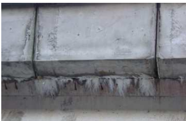
Obrázek 8: Zatékání mezi spárami prefabrikovaných konzol a nosné konstrukce [14]
