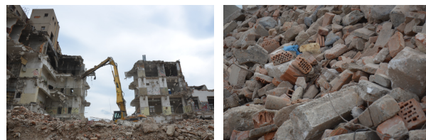
(a) Probíhající práce na demolovaných objektech. (b) Neroztříděná stavební suť z demolic.
