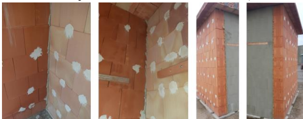
Obrázek 11: Stav montážní spáry po třech měsících – bezměřeny
