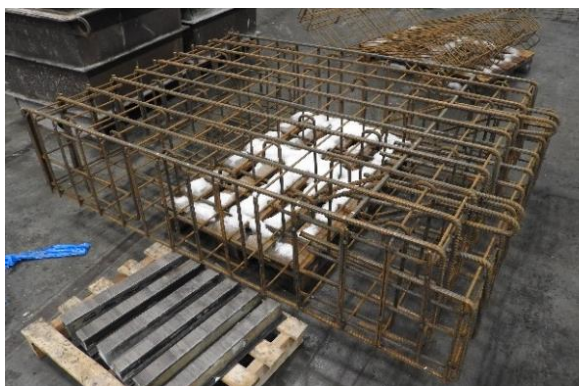
Obrázek 2: Vyzávaná výztuž zkušební tělesa
