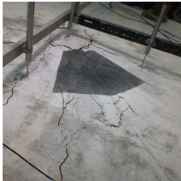
Obr. 04: Detail trhlín desky 1 – viditelné poškození v blízkosti lokálního zatížení [5]
