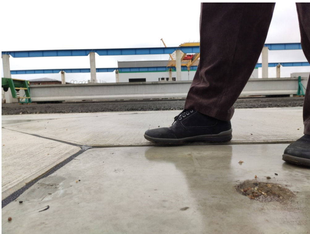
Obr. 11 Odchylka ve výškovém uložení prefabrikovaných dílců
