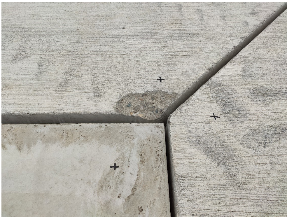
Obr. 13 Lokální porušení dílce při montáži
